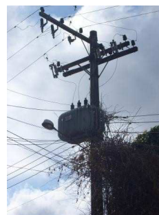
Figura 09 - Linha de Distribuição
