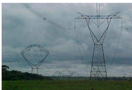
Figura 08- Linha de Transmissão.
