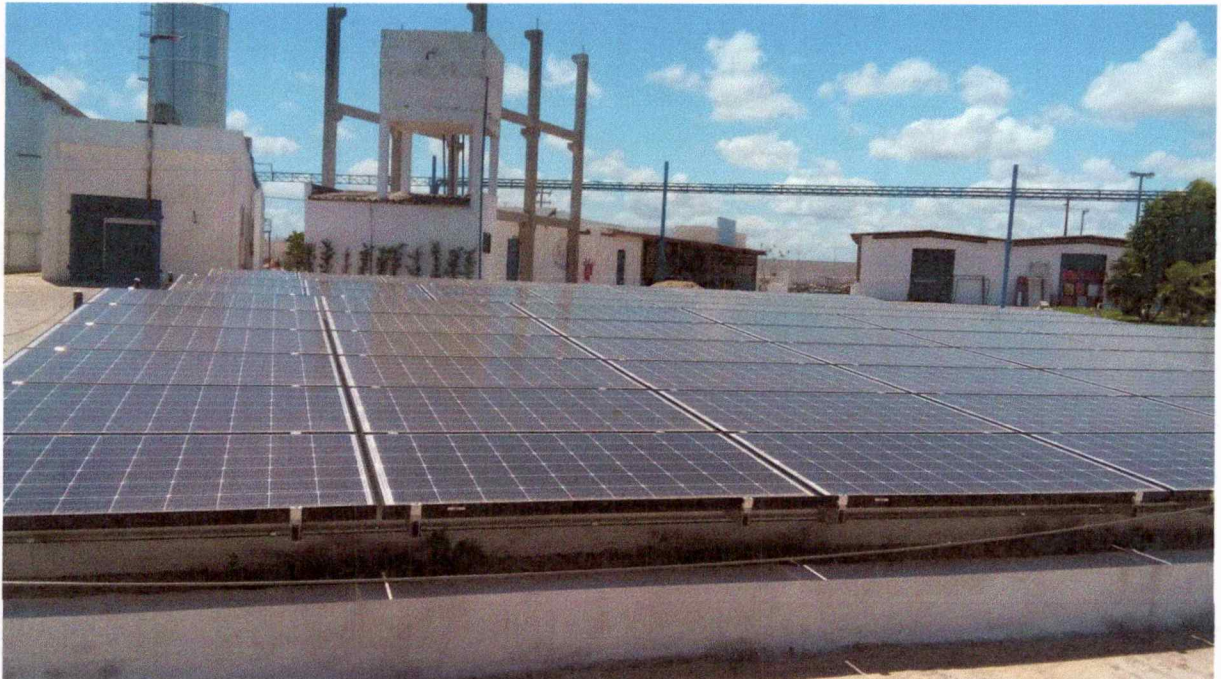
Placas de energia Solar
